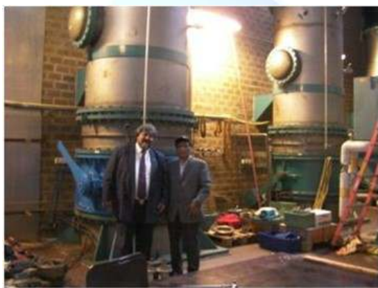
ESTACION DE BOMBEO DE AGUA SUBTERRANEA P.T.A.P. EN SUECIA
