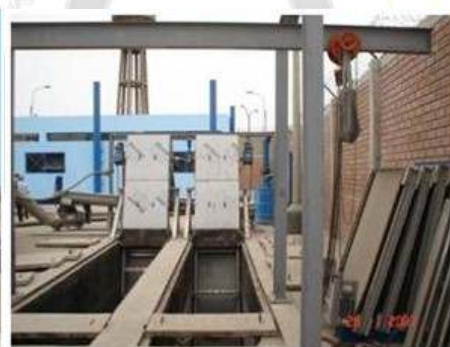
ESTACION DE BOMBEO AGUAS RESIDUALES CALLAO-PERU
