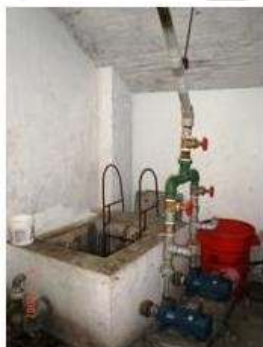
CAMARA DE BOMBEO EN EDIFICIO
