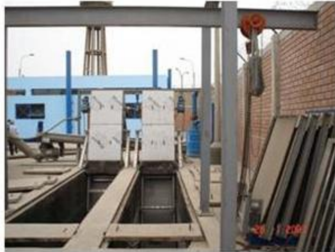
ESTACION DE BOMBEO AGUAS RESIDUALES CALLAO-PERU
