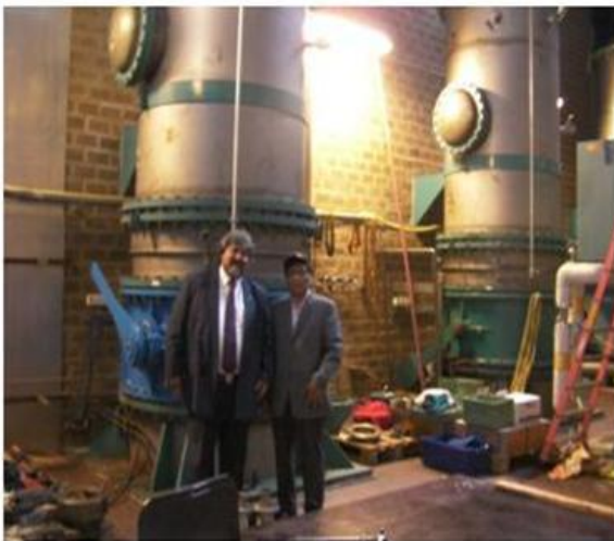
EST. BOMBEO DE AGUA SUBTERRANEA P.T.A.P. EN SUECIA
