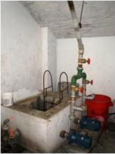
CAMARA DE BOMBEO EN EDIFICIO
